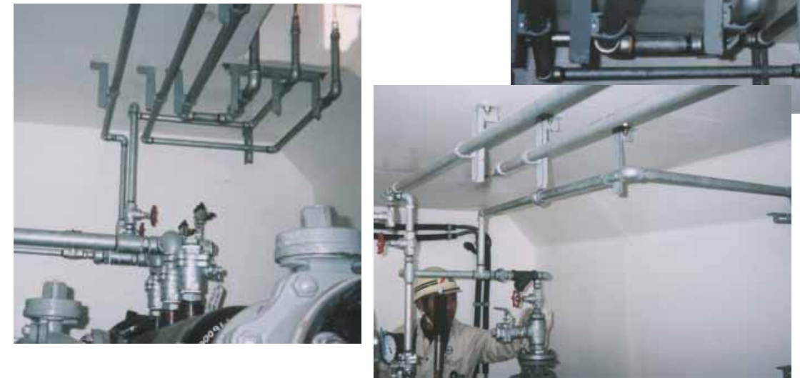
北海道ガス株式会社殿 (ガバナーステーション内部のガス配管支持にご採用) 施工場所：北海道千歳市
