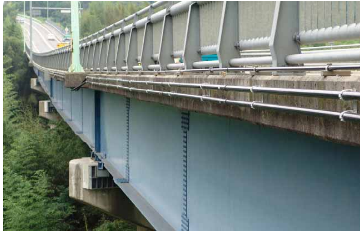
設置箇所全景
